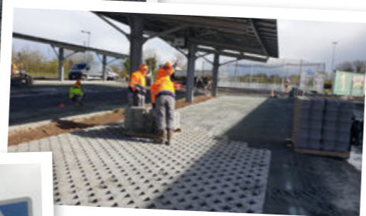
Réfection des parkings
